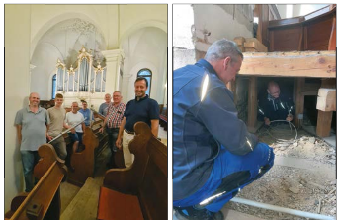
Geballte Fachkompetenz ausschließlich einheimischer Handwerker werden gleichnamiger Elektrofirma gemeinsam benötigt, um in feinem Zusammenspiel mit dem technischen Leiter des Schlosses Eckhard Müller in unwegsamem, v. a. (v.l. Thomas Lantzsch, Jonas Findeisen, engen Terrain unter den Emporbänken. Andre Molch, Carsten Lohse, herbert König, Jürgen Findeisen, Reinhard Arnold inmitten eines Meeres aus Orgelpfeifen)
