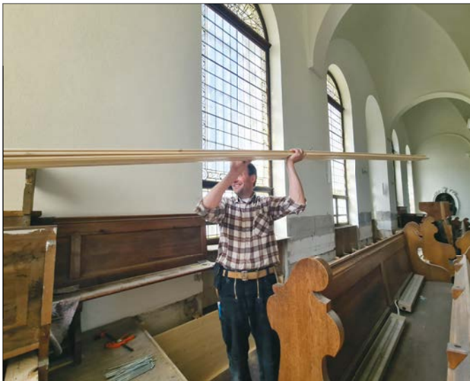
Reinhard Arnold auf der Empore bei der Endmontage der Holzdielung Fotos: Matthias Moser
